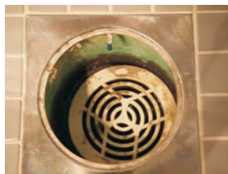
Sølvkre finner man ofte i forbindelse med sluk på bad og vaskerom.
