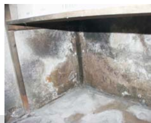
De kan også forekomme i kjellere med noe fuktproblem.
